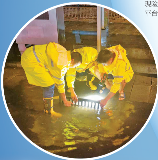
重庆市专业应急救援渝中支队队员处置城市内涝。
