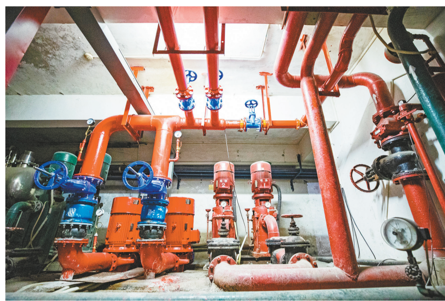
金汤大厦改造升级后的水泵房。
